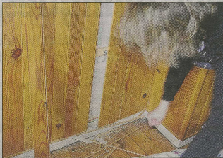
La puissance de la foudre a fait sauter les prises électriques et le lambris.
